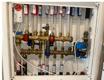
Samleskap med rørkurser og stoppekraner
