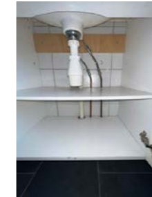
Røropplegg under vask på bad.
