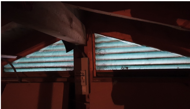
Luft ventil i gavl
