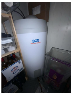
Varmtvannsbereder montert i teknisk rom.
