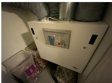
Balansert ventilasjonsanlegg, aggregat montert i teknisk rom.
