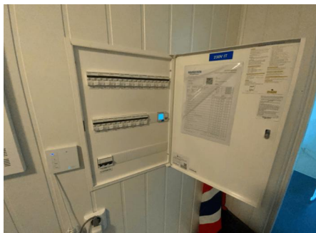
El-anlegg med automatsikringer.
