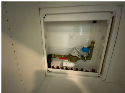
Stoppekran montert i underetasje.
