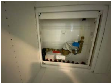
Stoppekran montert i underetasje.
