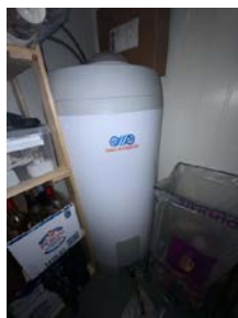
Varmtvannsbereder montert i teknisk rom.
