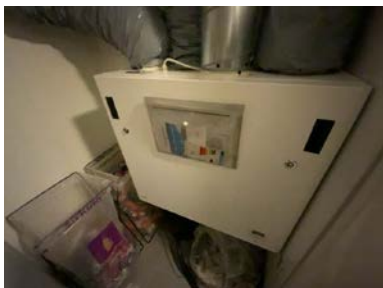
Balansert ventilasjonsanlegg, aggregat montert i teknisk rom.
