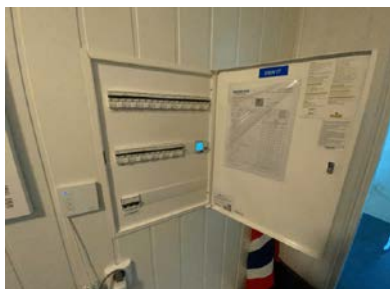
El-anlegg med automatsikringer.
