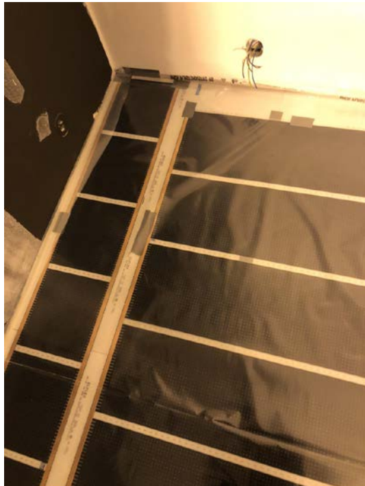
Skjema: "Skjult varme dokumentasjon: Varmefolie Stue + Kjøkken" Filnavn: A59C5B3D-7738-4B82-A058-328232E18B47.jpg
