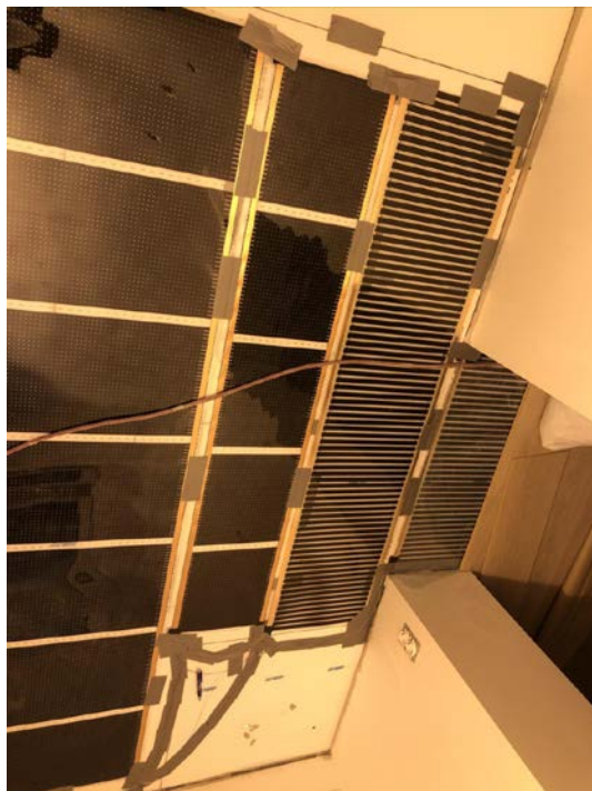
Skjema: "Skjult varme dokumentasjon: Varmefolie Stue + Kjøkken" Filnavn: A3C09121-9F5F-43FA-BEF2-7CC9E9F86656.jpg
