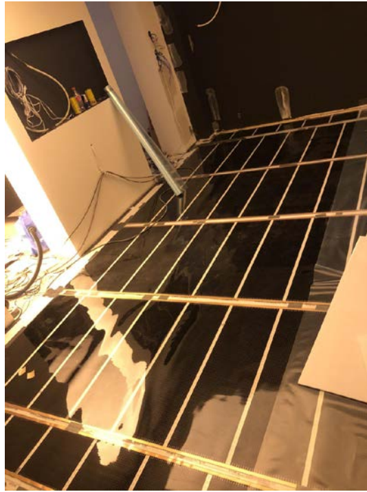
Skjema: "Skjult varme dokumentasjon: Varmefolie Stue + Kjøkken" Filnavn: A3926613-B289-47B8-BBA4-841EDAFDCC78.jpg
