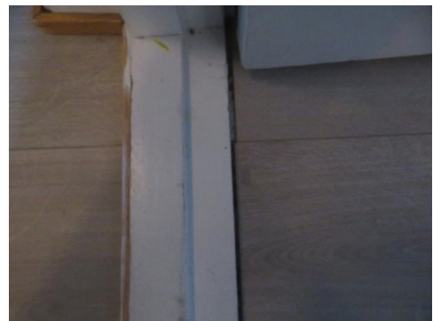
Manglende tetting mot terskel.
