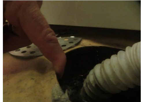
Løst belegg i sluk.
