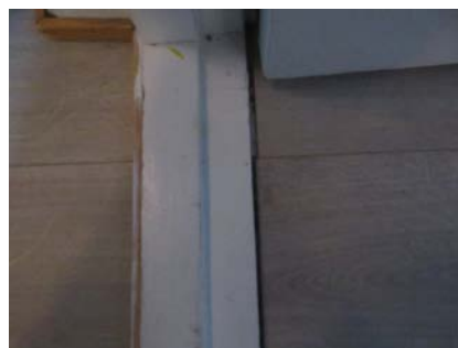
Manglende tetting mot terskel.
