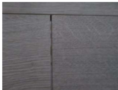
Skjøter i gulv som ikke er sammen.
