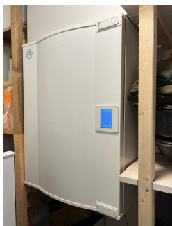
Ventilasjonsanlegg i teknisk rom.
