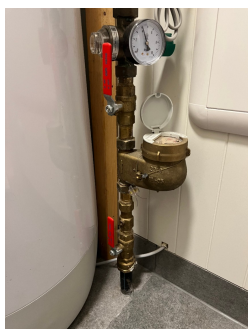
Vanninntak/stoppekranner i teknisk rom.
