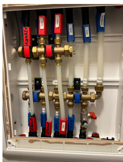
Rørskap i teknisk rom. Kursene er merket.
