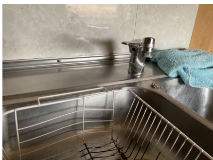
Armatur/blandebatteri er ikke tett.
