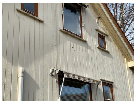
Mindre råteskade registrert over vindu.
