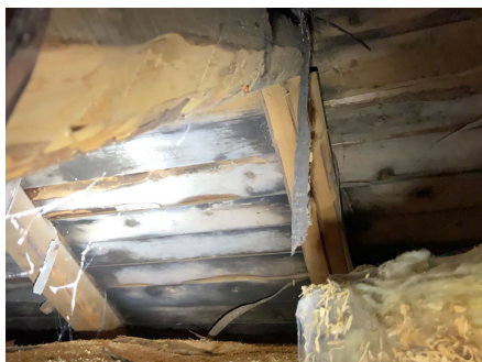
Misfarging på hele undertaket.
