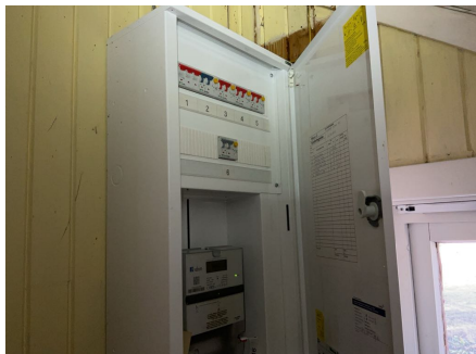
Sikringskap plassert i loftsetasje.
