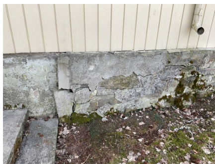
Forvitring av murpuss.
