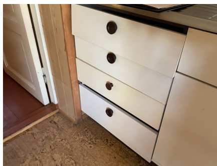
Skader på innredning.
