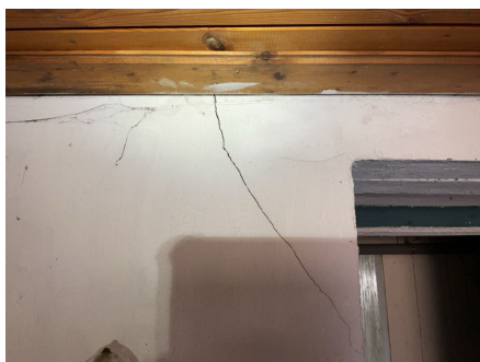
Sprekker i grunnmur.
