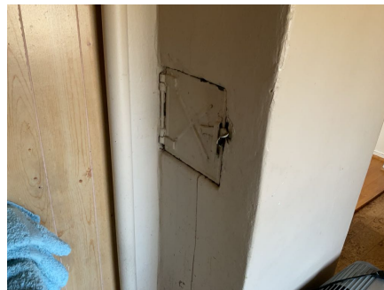
Sotluke plassert på kjøkken.
