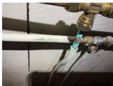
Irr/korrodering på rør.
