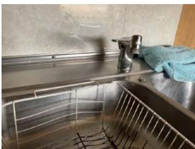
Armatur/blandebatteri er ikke tett.
