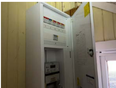
Sikringsskap plassert i loftsetasje.
