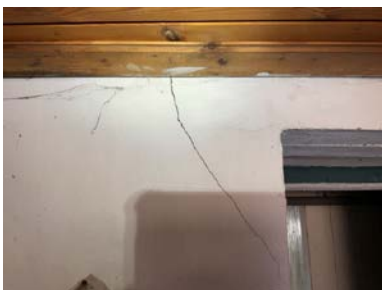
Sprekker i grunnmur.
