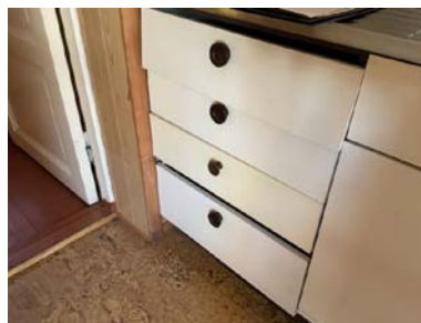
Skader på innredning.
