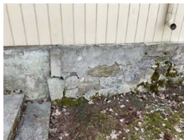
Forvitring av murpuss.
