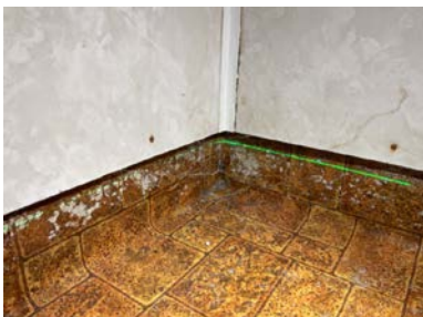
Svelling og fuktskader på vegger. Plater er også perforert med skruer i bunn.
