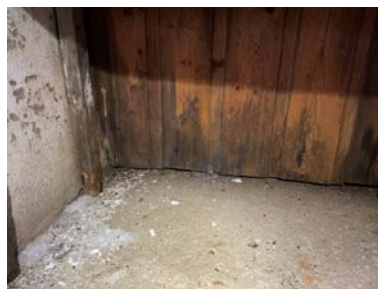
Fukt og råteskader på kledde vegger i kjeller.
