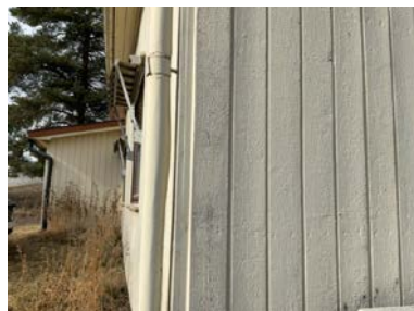
Frostspreng på takrennenedløp.
