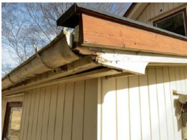
Råteskader på vindskier.
