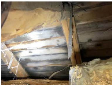
Misfarging på hele undertaket.
