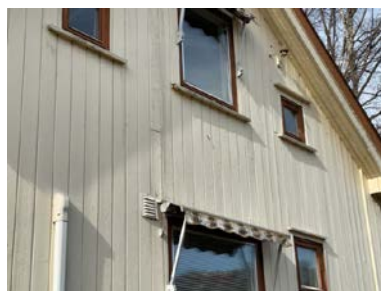
Mindre råteskade registrert over vindu.
