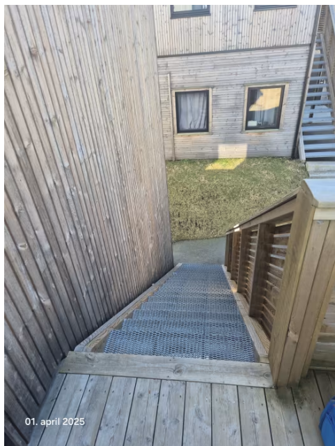
Bildet viser manglende håndløper på husveggen.
