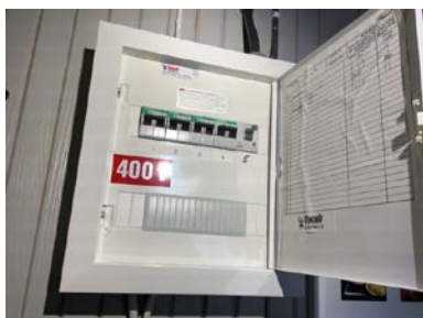
Sikringskap plassert i toalettrom.
