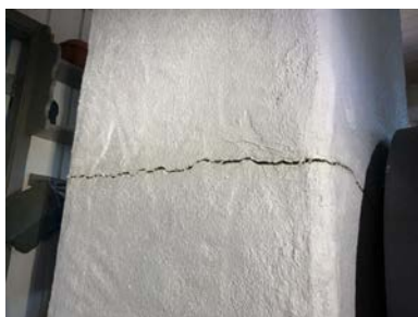
Større sprekke i pipe registrert. Forholdet gis tilstandsgrad 3.
