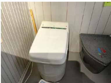
Forbrenningstoalett er ikke funksjonstestet.
