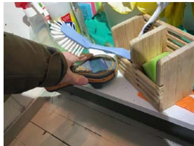
Svelling på bunnplate benkeskap, fuktsøk viste normale verdier.
