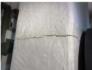
Større sprekke i pipe registrert. Forholdet gis tilstandsgrad 3.
