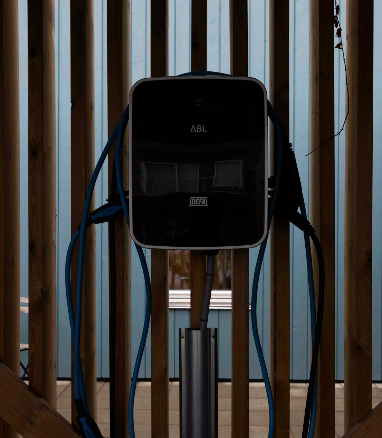
Det er montert dobbel elbil-lader i carport, god effekt (ca. 6,6kW).
