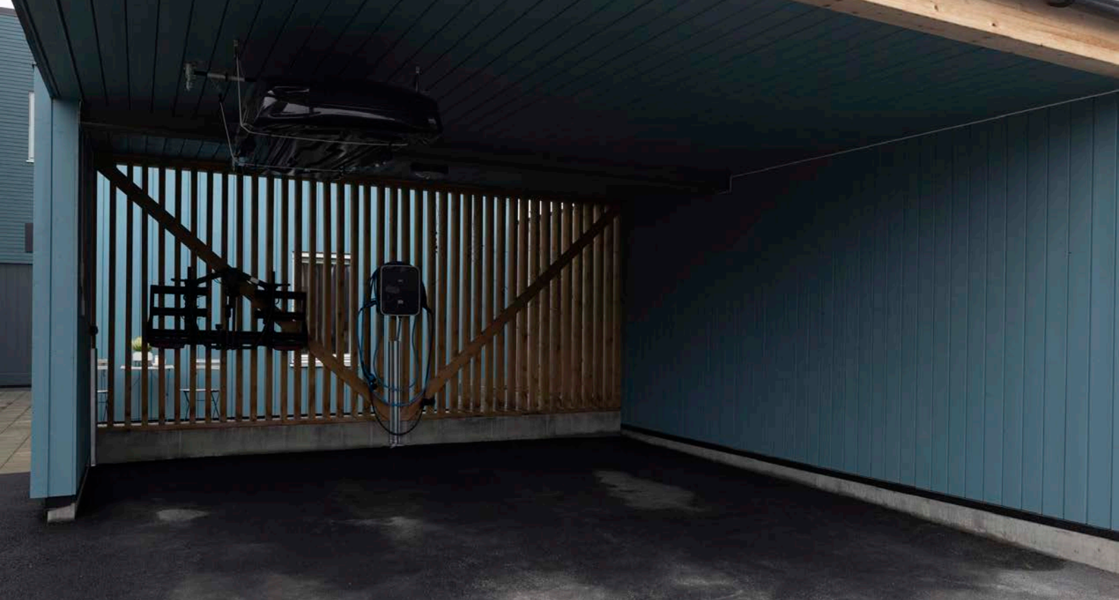
Dobbel carport på ca. 29m 2 med asfaltert dekke. Det er montert dobbel elbil-lader, lys og strøm.
