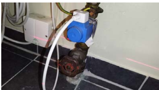
Hovedstoppekran. Det er montert vannstoppesystem.
