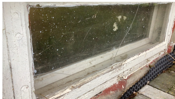
Sprukket glass i vindu.
