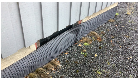
Fuktsperre er ikke rettskåret over terreng
