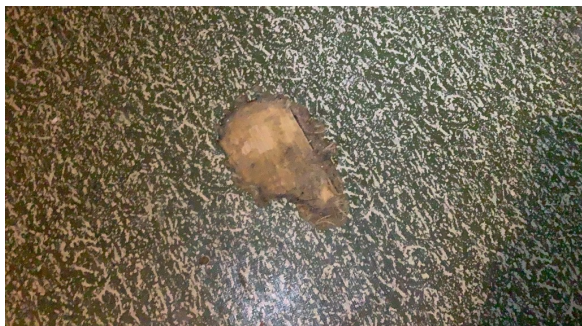
Slitasje i gulvbelegg.
