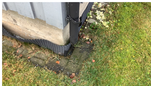
Mangelfull bortledning av takvann.
