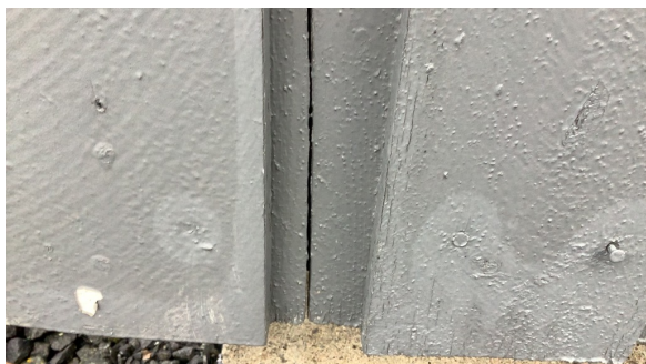
Eksempel på sprukket kledning.
