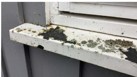
Værslitt vannbrettbeslag med mosedannelse.
