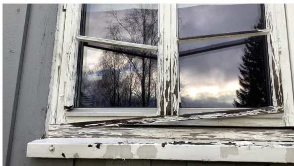
Værslitt vindu med råteskadede sprosper.
