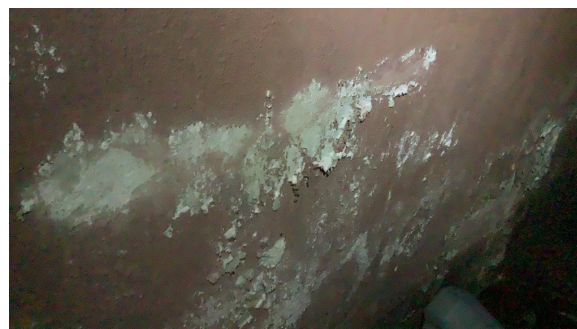
Eksempel på saltutslag på grunnmur.
