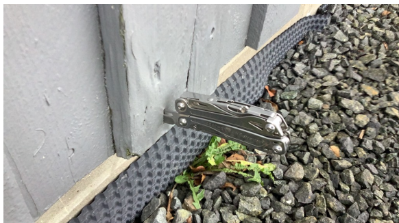
Eksempel på råteskadet kledning.
