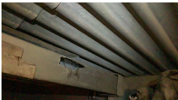
Skadet luftekanal av asbest og det er brannhemmende plater av eternitt i himling.
