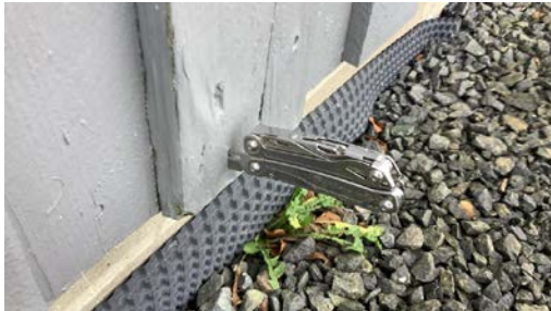
Eksempel på råteskadet kledning.
