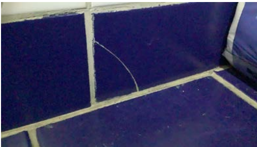
Sprukket flis på vegg.
