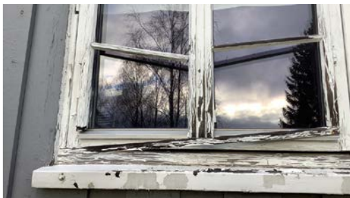
Værslitt vindu med råteskadede sprosper.
