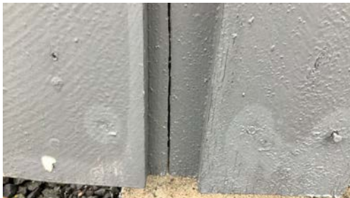
Eksempel på sprukket kledning.
