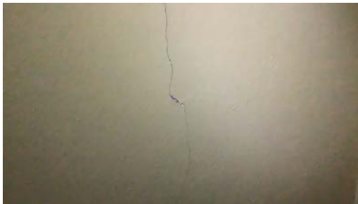
Riss i puss på pipe.
