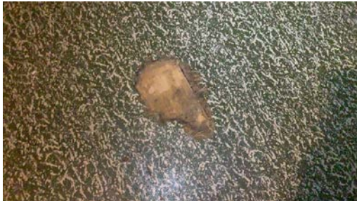
Slitasje i gulvbelegg.
