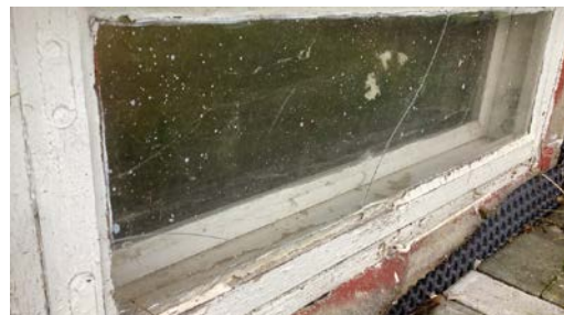
Sprukket glass i vindu.
