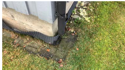
Mangelfull bortledning av takvann.
