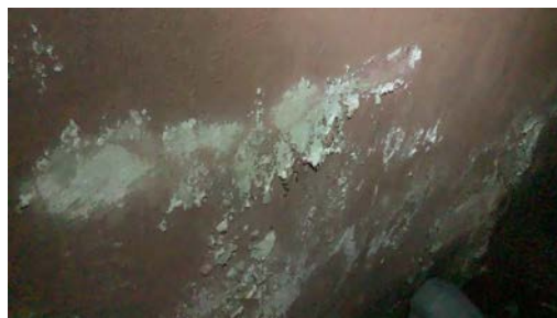
Eksempel på saltutslag på grunnmur.
