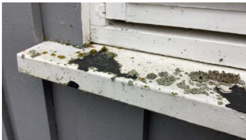
Værslitt vannbrettbeslag med mosedannelse.
