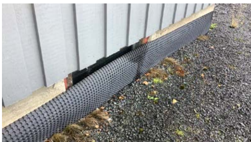
Fuktsperre er ikke rettskåret over terreng
