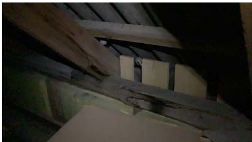
Fuktskjolder, men det måles tørt.
