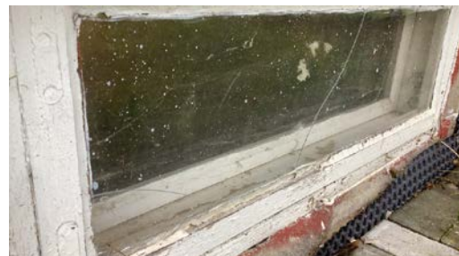
Sprukket glass i vindu.
