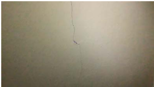
Riss i puss på pipe.
