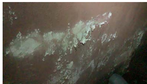
Eksempel på saltutslag på grunnmur.
