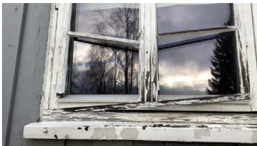
Værslitt vindu med råteskadede sprosper.
