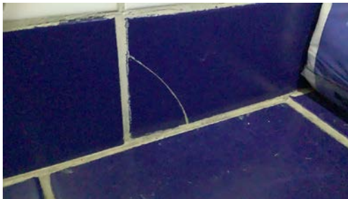
Sprukket flis på vegg.
