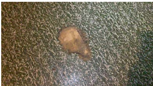
Slitasje i gulvbelegg.
