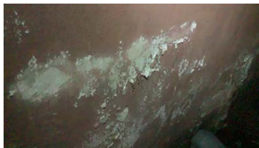
Eksempel på saltutslag på grunnmur.
