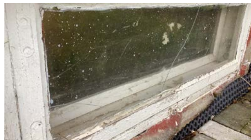
Sprukket glass i vindu.
