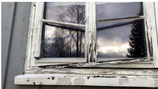
Værslitt vindu med råteskadede sprosper.
