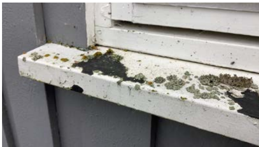
Værslitt vannbrettbeslag med mosedannelse.
