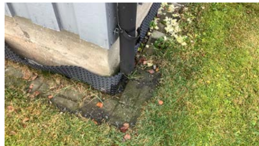
Mangelfull bortledning av takvann.
