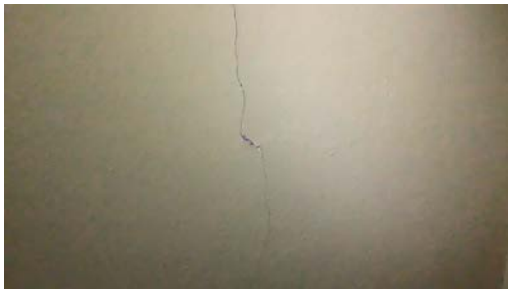
Riss i puss på pipe.
