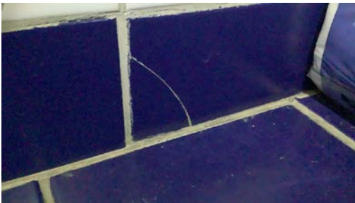
Sprukket flis på vegg.
