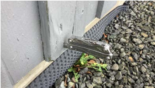
Eksempel på råteskadet kledning.
