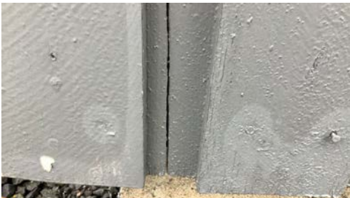
Eksempel på sprukket kledning.
