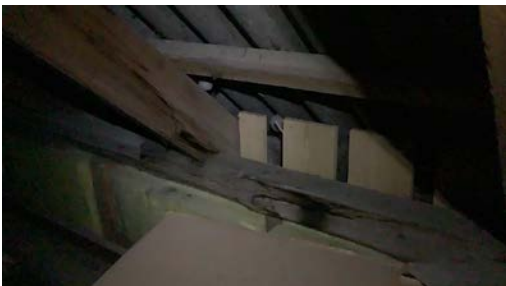
Fuktskjolder, men det måles tørt.
