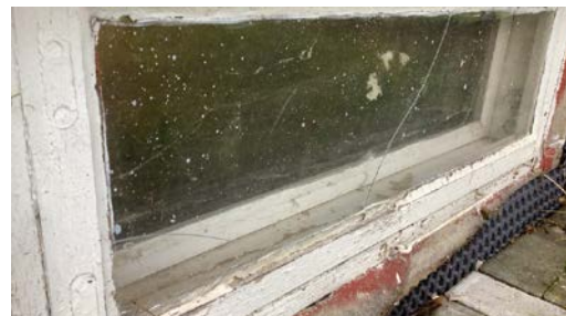
Sprukket glass i vindu.
