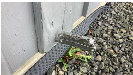
Eksempel på råteskadet kledning.
