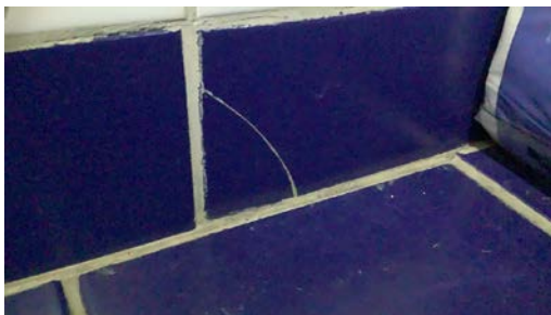
Sprukket flis på vegg.
