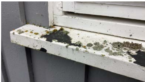
Værslitt vannbrettbeslag med mosedannelse.
