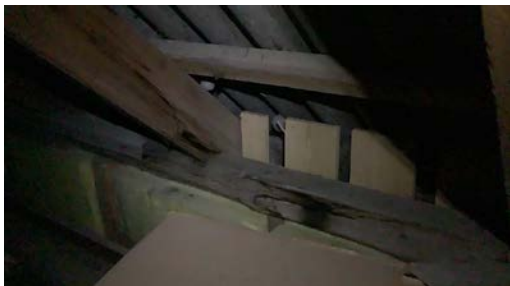
Fuktskjolder, men det måles tørt.
