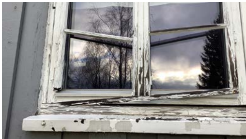
Værslitt vindu med råteskadede sprosser.
