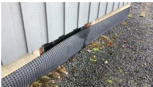
Fuktsperre er ikke rettskåret over terreng
