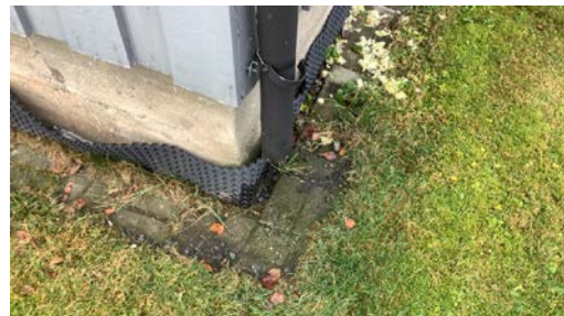
Mangelfull bortledning av takvann.
