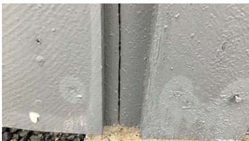
Eksempel på sprukket kledning.
