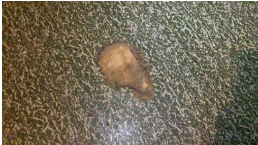
Slitasje i gulvbelegg.
