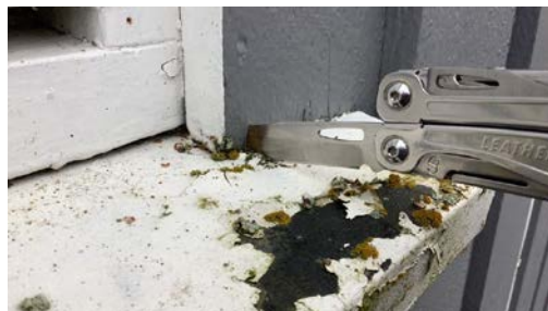
Omramming er ført helt ned til vannbrett og dette har ført til spredte råteskader.
