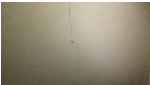
Riss i puss på pipe.
