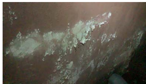
Eksempel på saltutslag på grunnmur.
