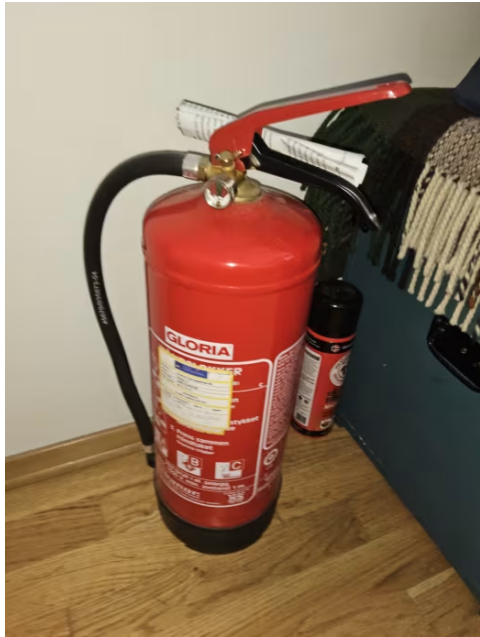
Bilde viser brannslukningsapparat.
