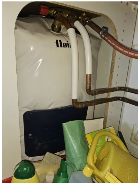
Bilde viser varmtvannsbereder.
