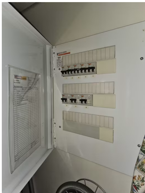
Bilde viser sikringsskap.
