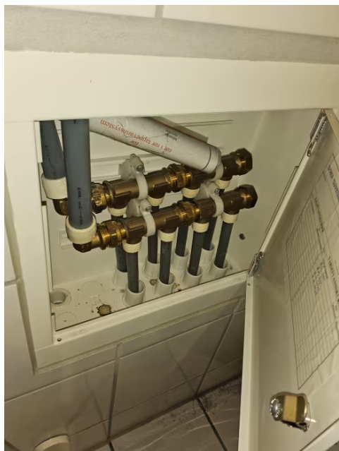
Bilde viser fordelerskap for rør i rørsystem.
