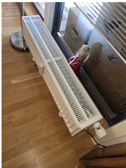
Bilde viser radiator i stue.
