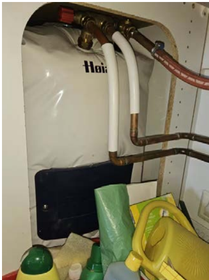
Bilde viser varmtvannsbereder.
