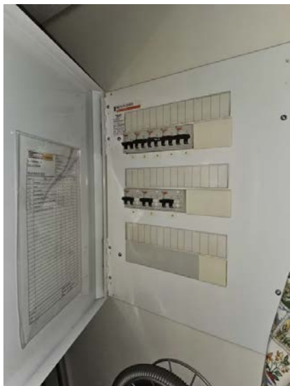
Bilde viser sikringsskap.
