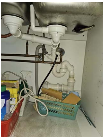
Bilde viser avløpsrør under oppvaskkum på kjøkken.
