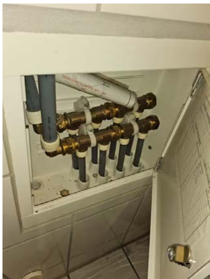
Bilde viser fordelerskap for rør i rørsystem.
