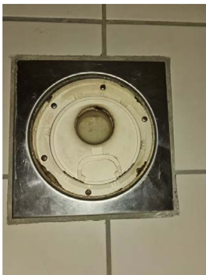
Bilde viser sluk på bad.
