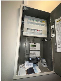
Sikringskap med automatsikringer.
