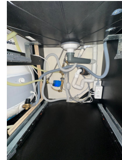
Rørøpplegg i kjøkkenbenk med Waterguard
