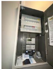
Sikringsskap med automatsikringer.
