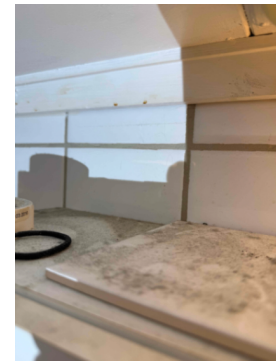
Bildet viser sprekk i veggflis over baderomsinnredningen.
