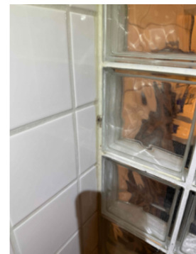
Bildet viser elastisk fugemasse (silikonfuge) med synlig svertesopp.
