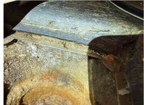
Bildet viser sluk med belegg uten klemring.
