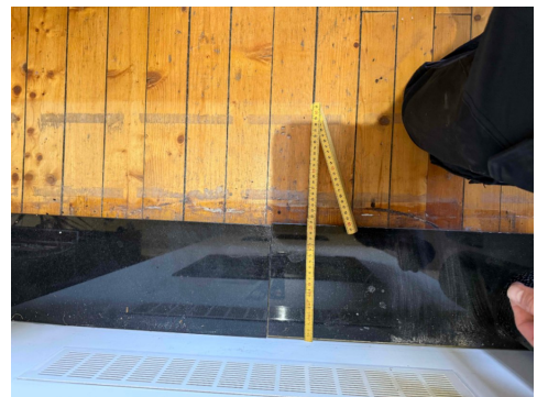
Bildet viser ildfast plate under ildsted i 1. etasje som ikke dekker minst 30 cm foran ildstedet.
