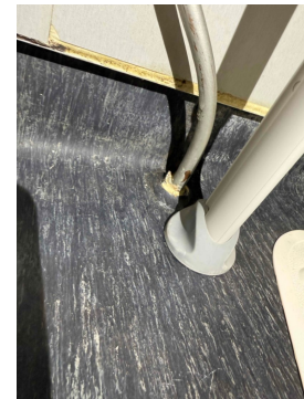
Bildet viser fuget rørgjennomføring i dusjsonen.
