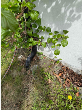
Bildet viser nedløp avsluttet ved grunnmur.
