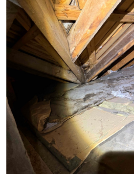
Bildet viser fuktskjolder på undertak.
