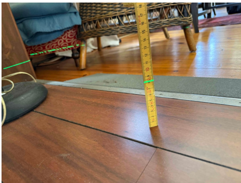
Bildet viser måling ved åpning til kjøkkenet.
