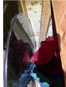
Bildet viser tegn på saltutsalg i boden innenfor vaskerommet.
