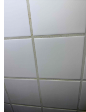
Bildet viser riss i flisfuger i dusjsonen.
