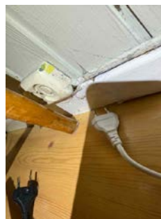
Bildet viser en skadet stikkontakt.
