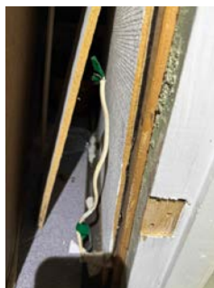
Bildet viser en strømlledning som ikke er tilfredsstillende avsluttet
