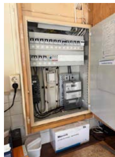
Bildet viser sikringsskapet plassert på kjøkkenet.
