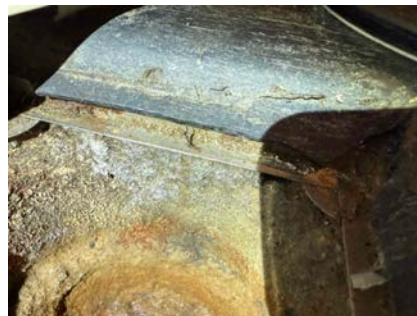
Bildet viser sluk med belegg uten klemring.
