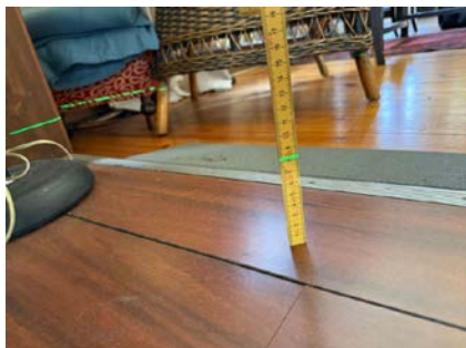
Bildet viser måling ved åpning til kjøkkenet.
