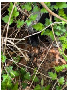
Bildet viser nedløp avsluttet ved grunnmur.
