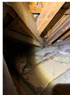
Bildet viser fuktskjolder på undertak.
