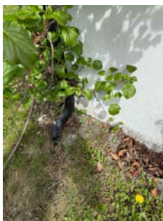
Bildet viser nedløp avsluttet ved grunnmur.
