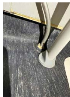
Bildet viser fuget rørgjennomføring i dusjsonen.
