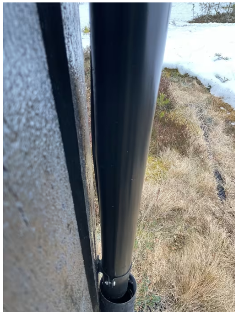
Frostspreng i nedløp
