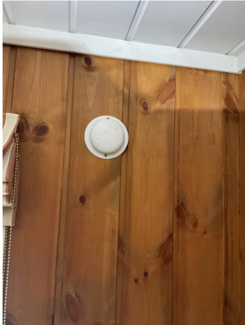
Ventil i vegg
