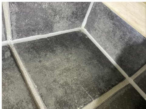
Sprekk i flis.
