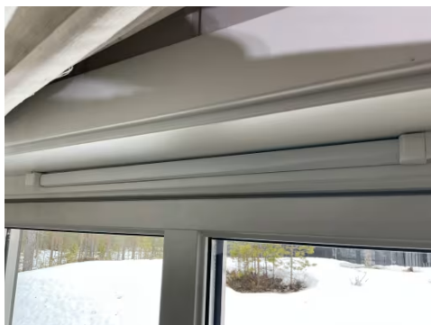
Klaffventil i vinduer
