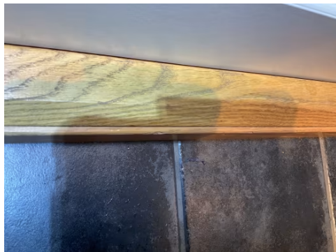
Manglende tettesjikt ved terskel.
