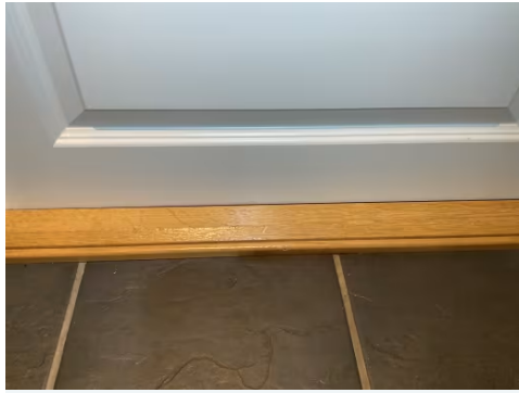
Manglende tilluft under dør.
