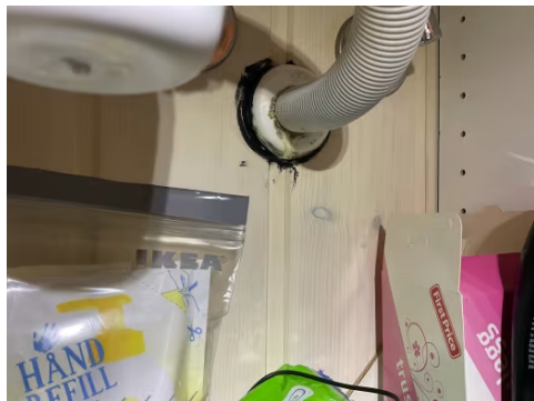
Fugemasse rundt avløp til servant.
