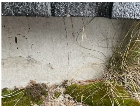
Sprekk i steinplate på ringmur
