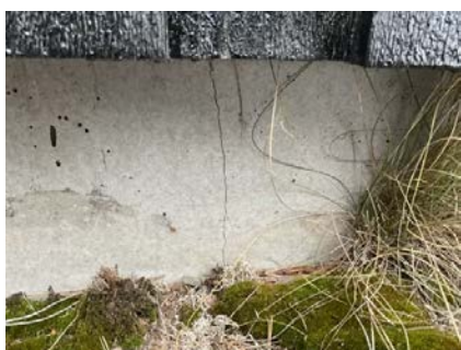
Sprekk i steinplate på ringmur
