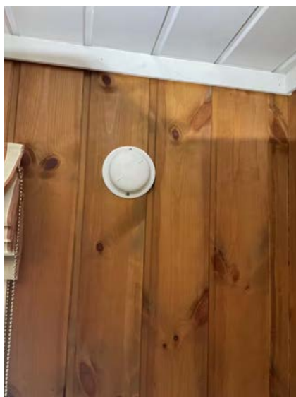
Ventil i vegg
