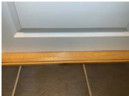
Manglende tilluft under dør.
