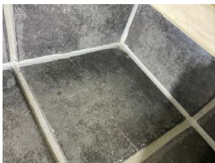
Sprekk i flis.
