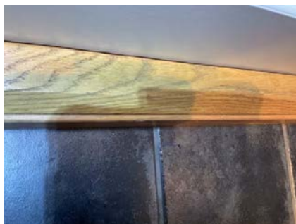
Manglende tettesjikt ved terskel.
