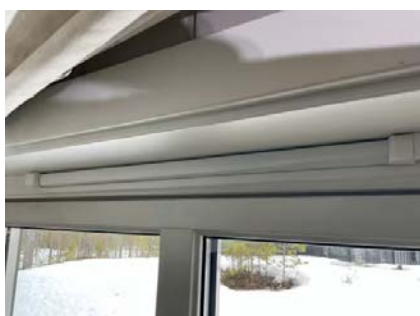
Klaffventil i vinduer
