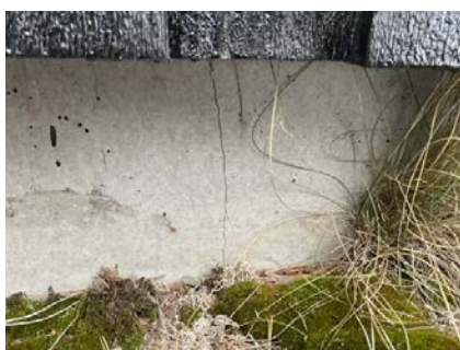
Sprekk i steinplate på ringmur
