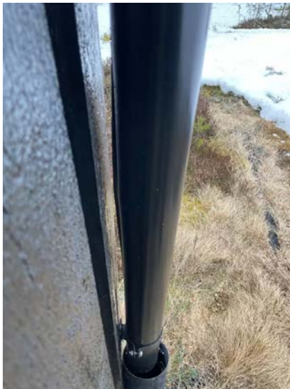
Frostspreng i nedløp
