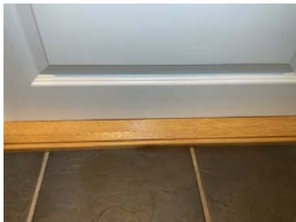
Manglende tilluft under dør.
