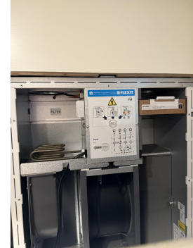
Bilde av ventilasjonsanlegg med et filter
