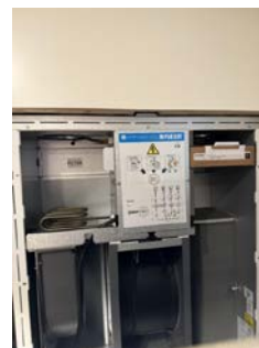
Bilde av ventilasjonsanlegg med et filter
