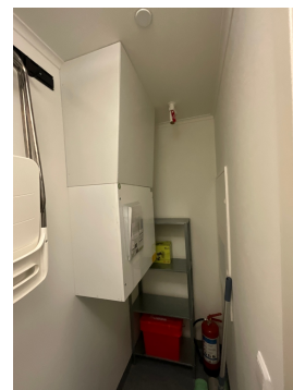
Ventilasjonsanlegg plassert i bod.
