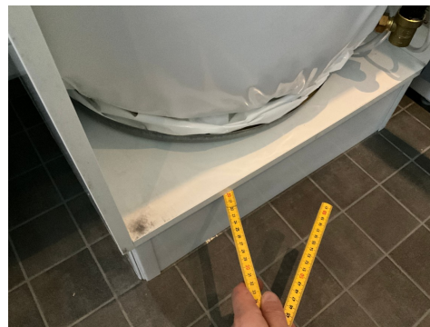
Ikke registrert understøttelse under skapbunn under varmtvannstanken.
