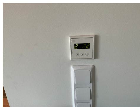
Styringspanel for ventilasjonsanlegg
