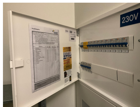
Sikringsskap med automatsikringer
