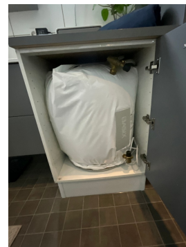
Varmtvannstank plassert i benkeskap i bad.
