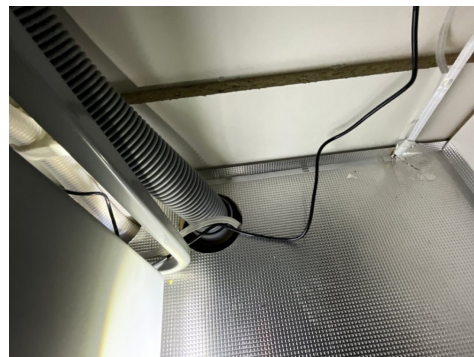
Avløpsrør av plast internt i boenheten
