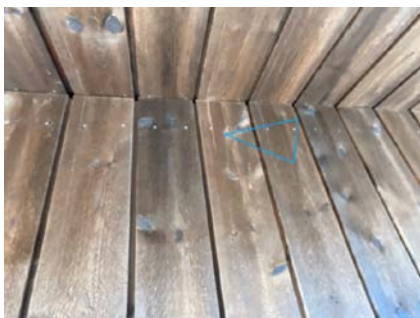
Registrert sprekk i kledningsbord på fasade ved veranda mot øst.
