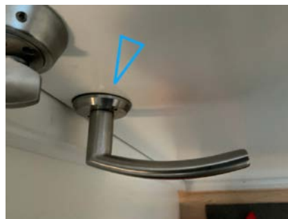
Løs dørrvrider innvendig på hovedytterdør
