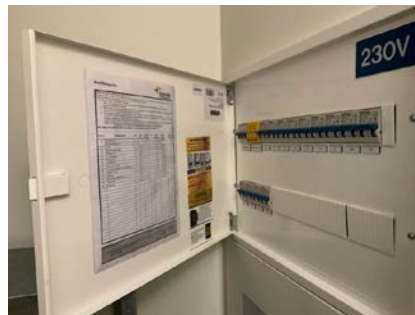
Sikringsskap med automatsikringer
