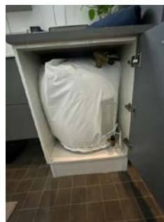
Varmtvannstank plassert i benkeskap i bad.
