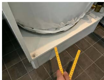
Ikke registrert understøttelse under skapbunn under varmtvannstanken.
