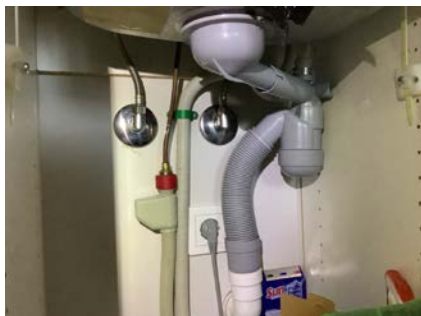
Rør i kjøkkenbenken
