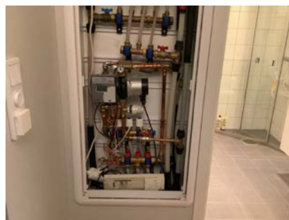
Fordelerskap i gang.
