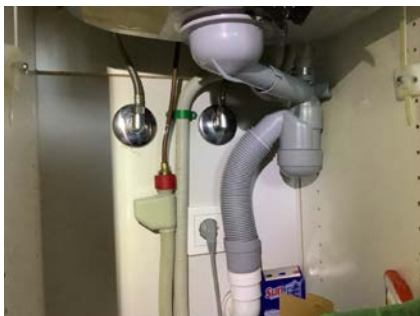
Rør i kjøkkenbenken
