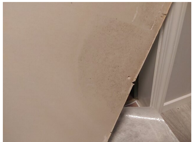
Bad leilighet 1 etg. Fukt i revet gipsplate. Litt sur lukt og muggprikker på gips.
