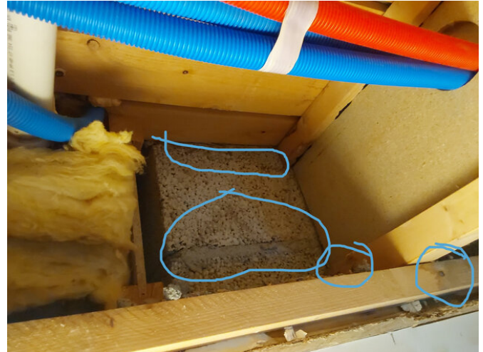
Bad leilighet 1 etg. Ut fra fuktmerker virker lekkasje å være knyttet til Lecapipe.
