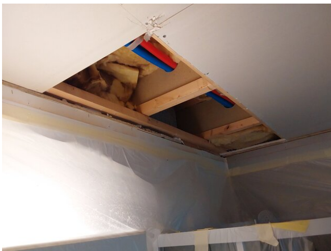
Bad leilighet 1 etg. Åpnet himling for lekkasjesøk.
