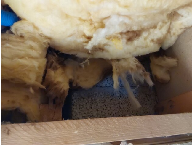
Bad leilighet 1 etg. Misfarget isolasjon mot Leca pipe
