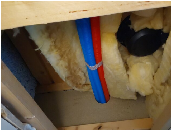
Bad leilighet 1 etg. Noe misfarget isolasjon. Mørkere mot farge mot pipe.
