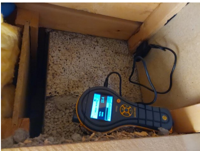
Bad leilighet 1 etg. Vannmerker på i-bjelke mot Leca pipe. Måler litt høyere fuktverdi på vannmerke, men fortsatt regnet som tørt. Fuktmerker på pipe.
