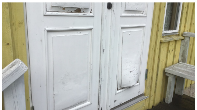
To fløyet ytterdør med fuktskader i dørspill
