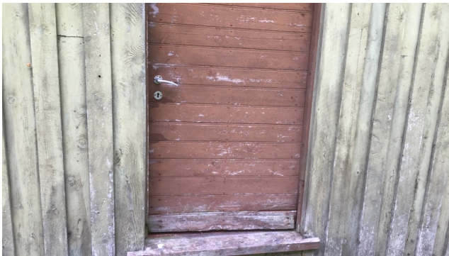
Utettheter i inngangsdør
