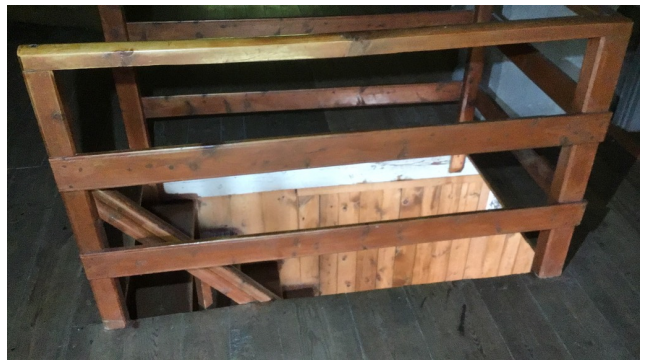
Store åpninger i rekkverket
