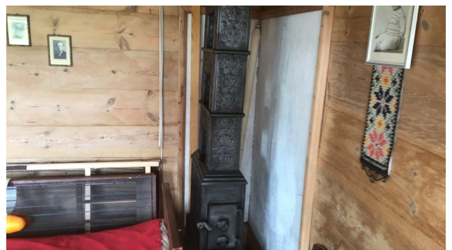
Ovn i stue nr 2, ikke tilkoblet pipe
