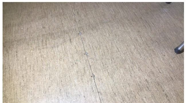
Utette skjøter i beleg
