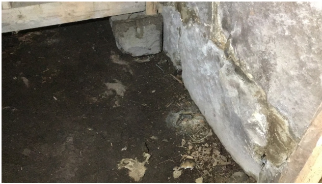
Fukt i gulv
