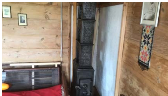
Ovn i stue nr 2, ikke tilkoblet pipe
