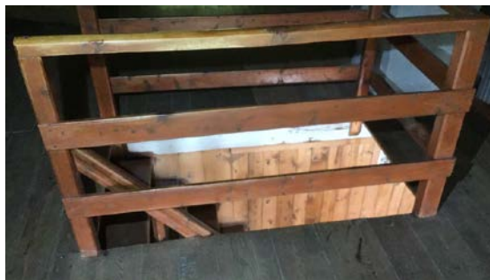
Store åpninger i rekkverket
