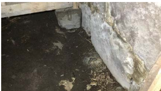
Fukt i gulv
