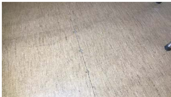
Utette skjøter i beleg
