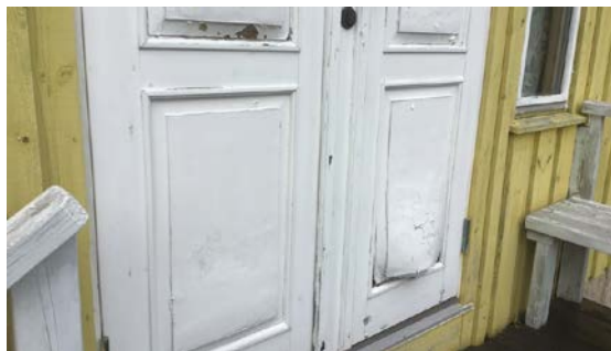
To fløyet ytterdør med fuktskader i dørspill
