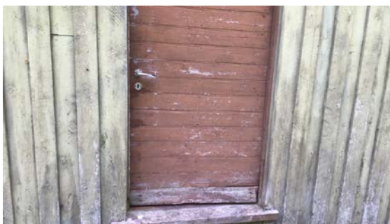
Utettheter i inngangsdør
