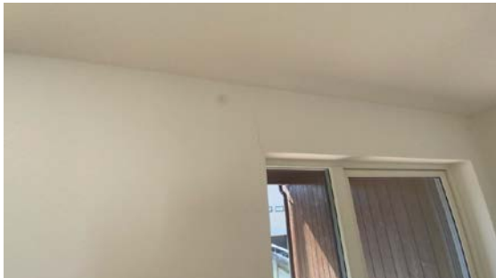
Synlige riss og flekker.
