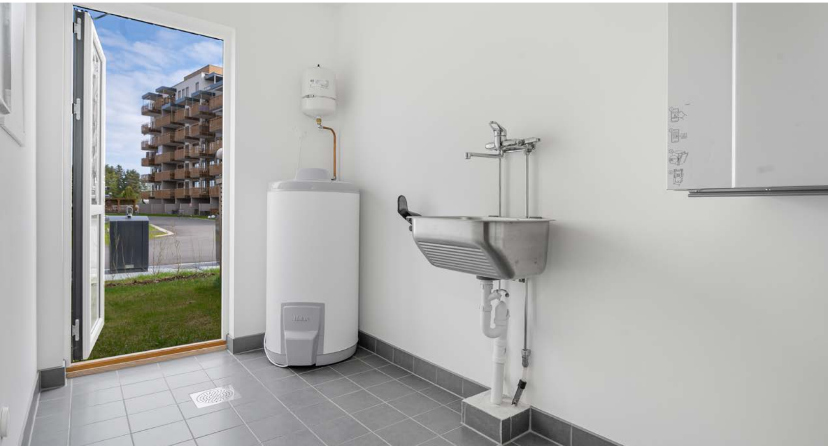
Praktisk vaskerom med utgang til hageflekk i bakkant av boligen. Her får skitne parkdresser eller fritidsklær kort vei til vaskemaskinen!
