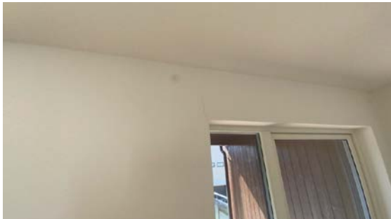
Synlige riss og flekker.
