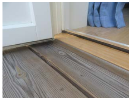
Ingen oppkant/høydeforskjell mellom balkong gulv og innvendig gulv/terskel.
