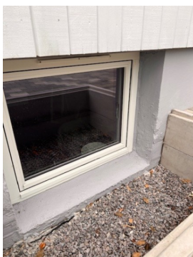
Vinduer i grunnmur mangler beslag under vindu.
