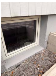
Vinduer i grunnmur mangler beslag under vindu.
