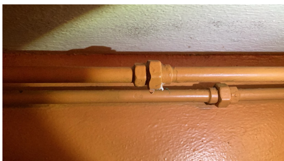
Det drypper fra flere rørsjøter.
