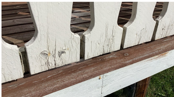
Eksempel på slitasje.
