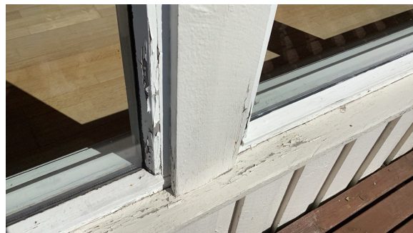
Eksempel på slitasje på vindu med isolerglass.
