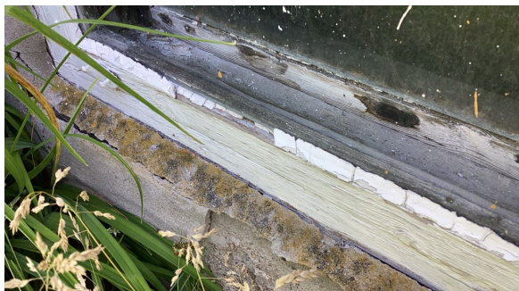
Eksempel på slitasje på vindu med enkle glass.
