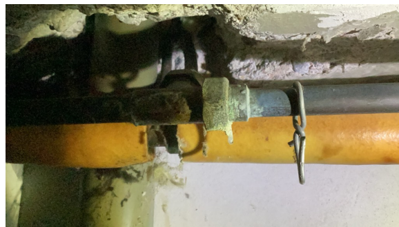
Det drypper fra flere rørsjøter.
