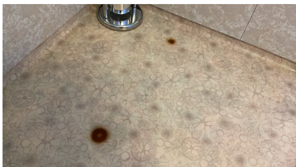
Misfarging på gulv.
