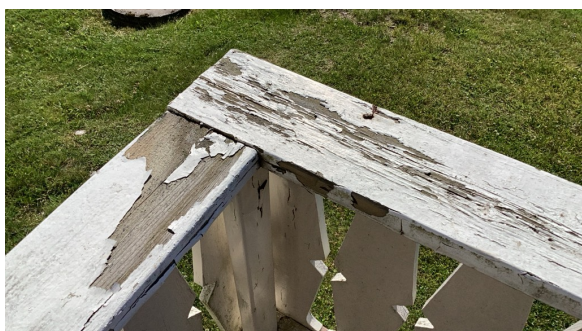
Eksempel på slitasje.
