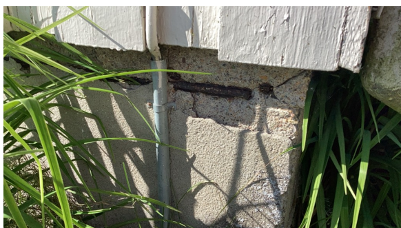
Eksempel på avskaling og synlig armering.
