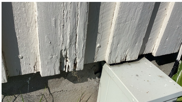
Eksempel på råte i kledningsbord.
