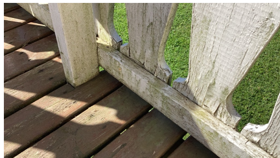
Eksempel på slitasje.
