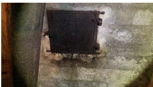
Sotluke i kjeller.
