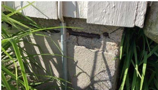
Eksempel på avskaling og synlig armering.
