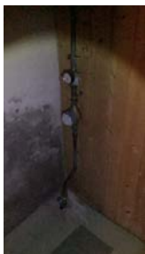
Vanninntak med måler og stoppekran i kjeller.
