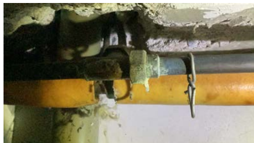
Det drypper fra flere rørskjøter.
