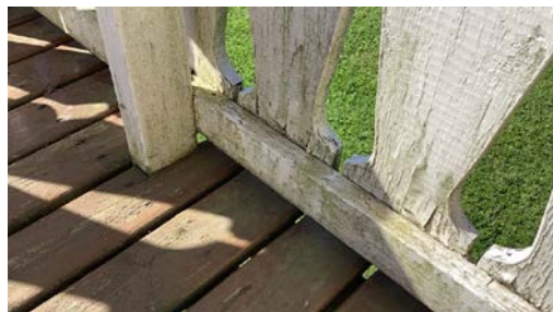
Eksempel på slitasje.
