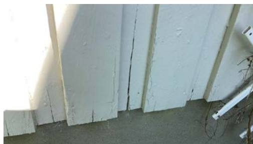
Eksempel på sprekk i kledningsbord.
