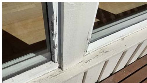
Eksempel på slitasje på vindu med isolerglass.
