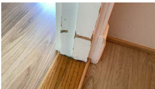
Eksempel på slitasje
