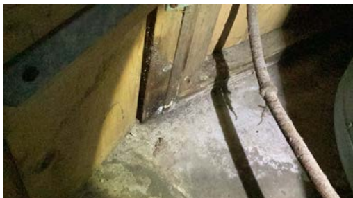
Begynnende fuktskader på trevegg.
