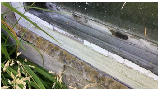
Eksempel på slitasje på vindu med enkle glass.
