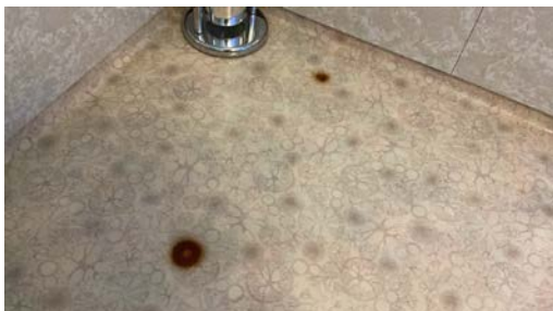
Misfarging på gulv.
