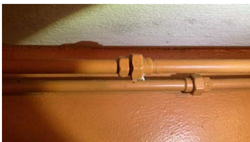
Det drypper fra flere rørskjøter.
