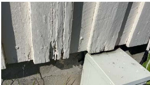
Eksempel på råte i kledningsbord.
