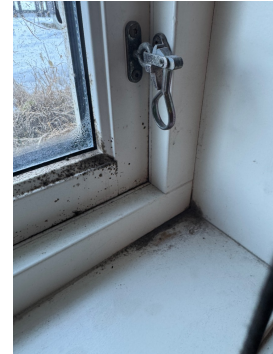
Sopp i vinduskarm soverom kjeller
