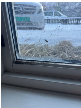
Sopp i vinduskarm soverom kjeller
