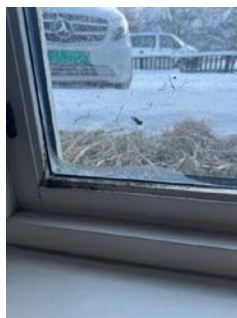
Sopp i vinduskarm soverom kjeller
