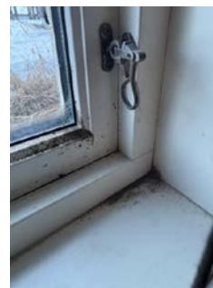
Sopp i vinduskarm soverom kjeller
