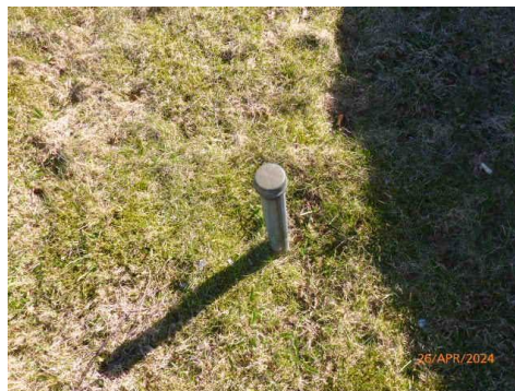
Utvendig stoppekran i nord.
