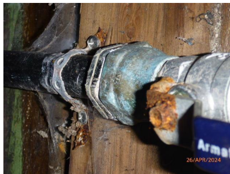
Plast på vannledning i krypkjeller.
